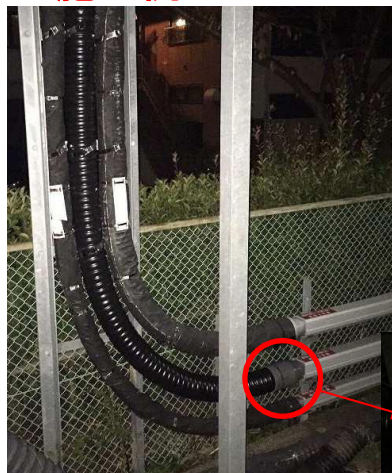
架空敷設ケーブル立上り箇所
